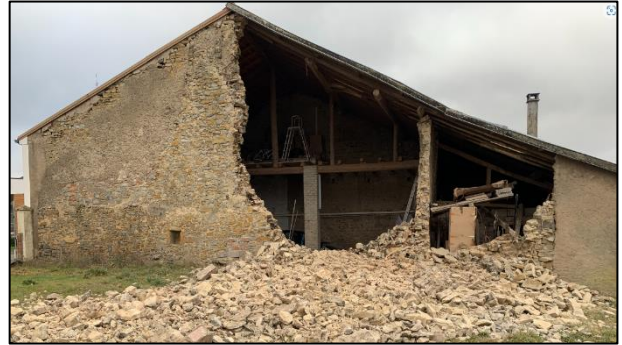
Photo du « mur mitoyen » partiellement effondré sur la parcelle 26
